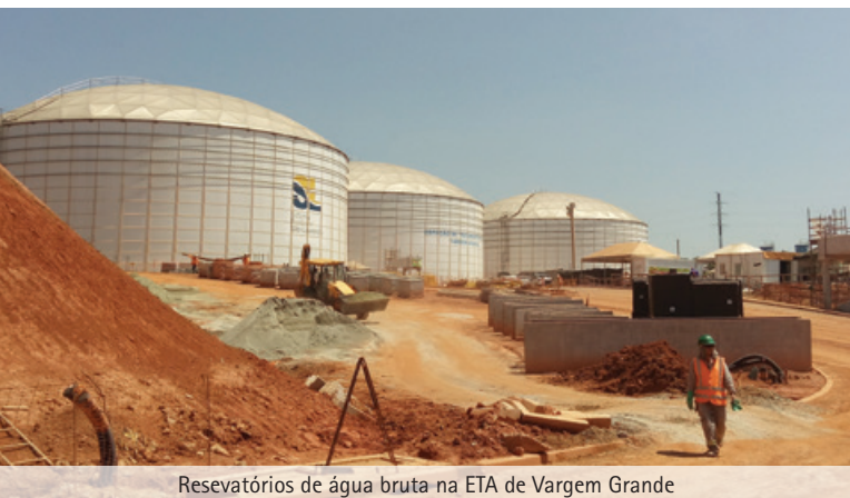
Reservatórios de água bruta na ETA de Vargem Grande
