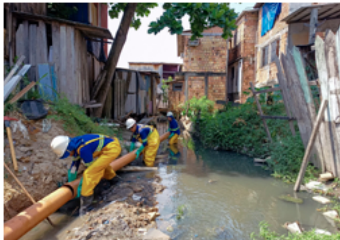
Canalização de rede de esgoto em palafitas, em Manaus
