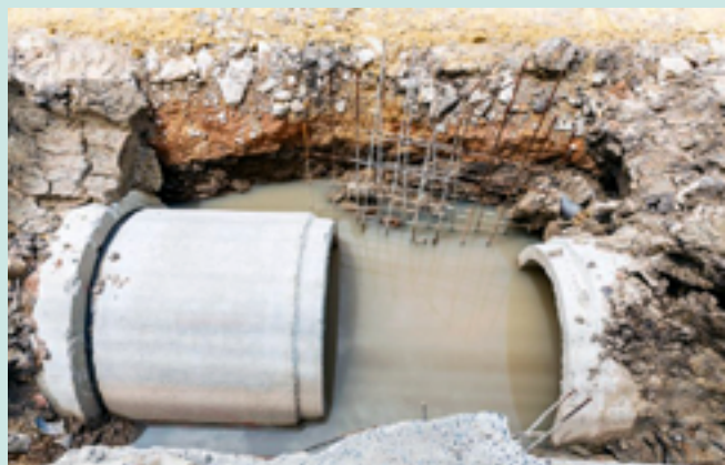
Obra de saneamento paralisada
